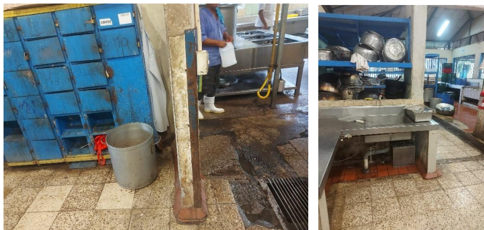
Fotos: pisos y paredes de la cocina con el cemento expuesto o en condiciones que dificultan la higiene.
