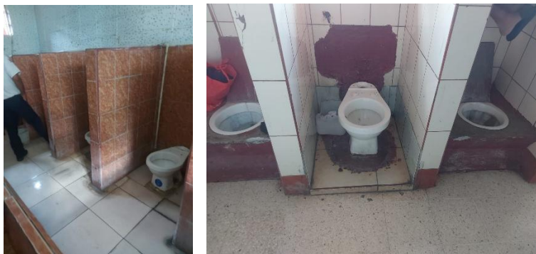
Fotos: servicios sanitarios son privacidad, algunos en desuso, otros con cemento expuesto lo que dificulta la higiene y propicia el acumulado de malos olores.
