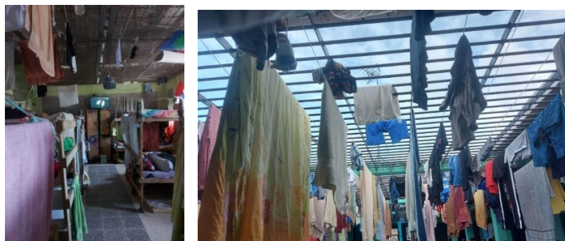
Fotos. A la izquierda: hacinamiento en Módulo en el que los pisos en la noche funcionan para poner espumas. A la derecha: único espacio para tender la ropa que obstruye el paisaje y la entrada de sol y aire libre.
