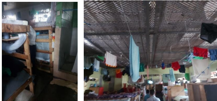
Fotos: Condiciones de hacinamiento en los Módulos que no son de baja contención. Camarotes de madera expuesta sin pintar, pisos donde se debe colocar espumas para dormir y afecta la higiene.
